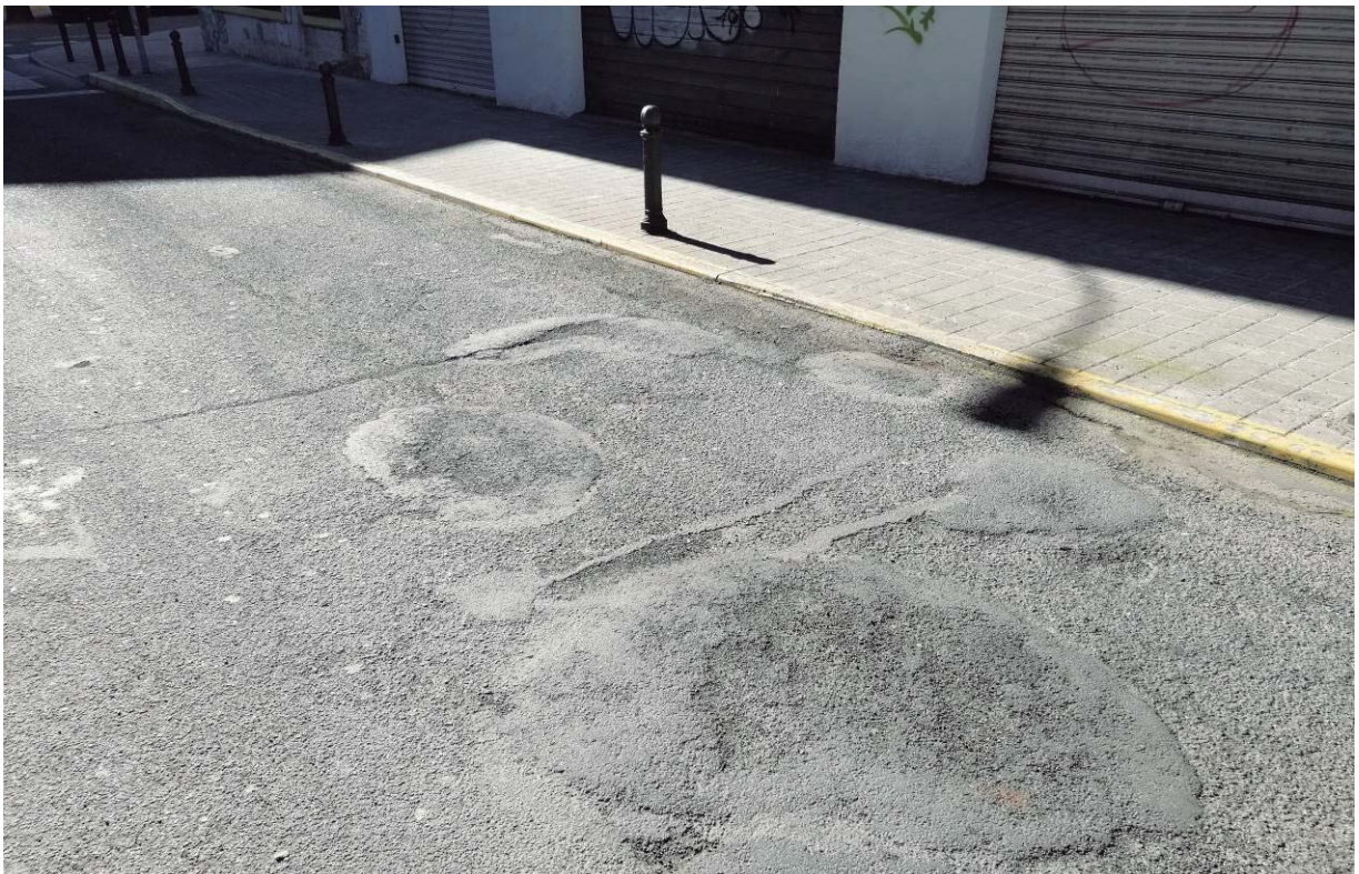
Asfaltado en mal estado con distintos parcheados por reparaciones puntuales.
