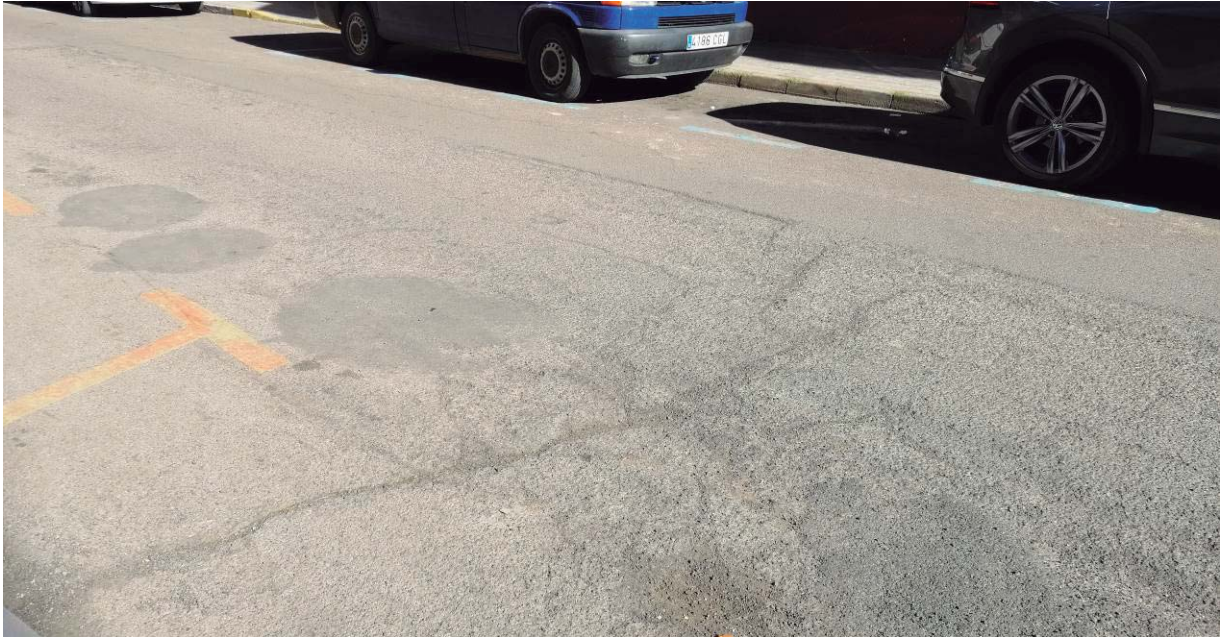
Asfaltado en mal estado con distintos parcheados por reparaciones puntuales.
