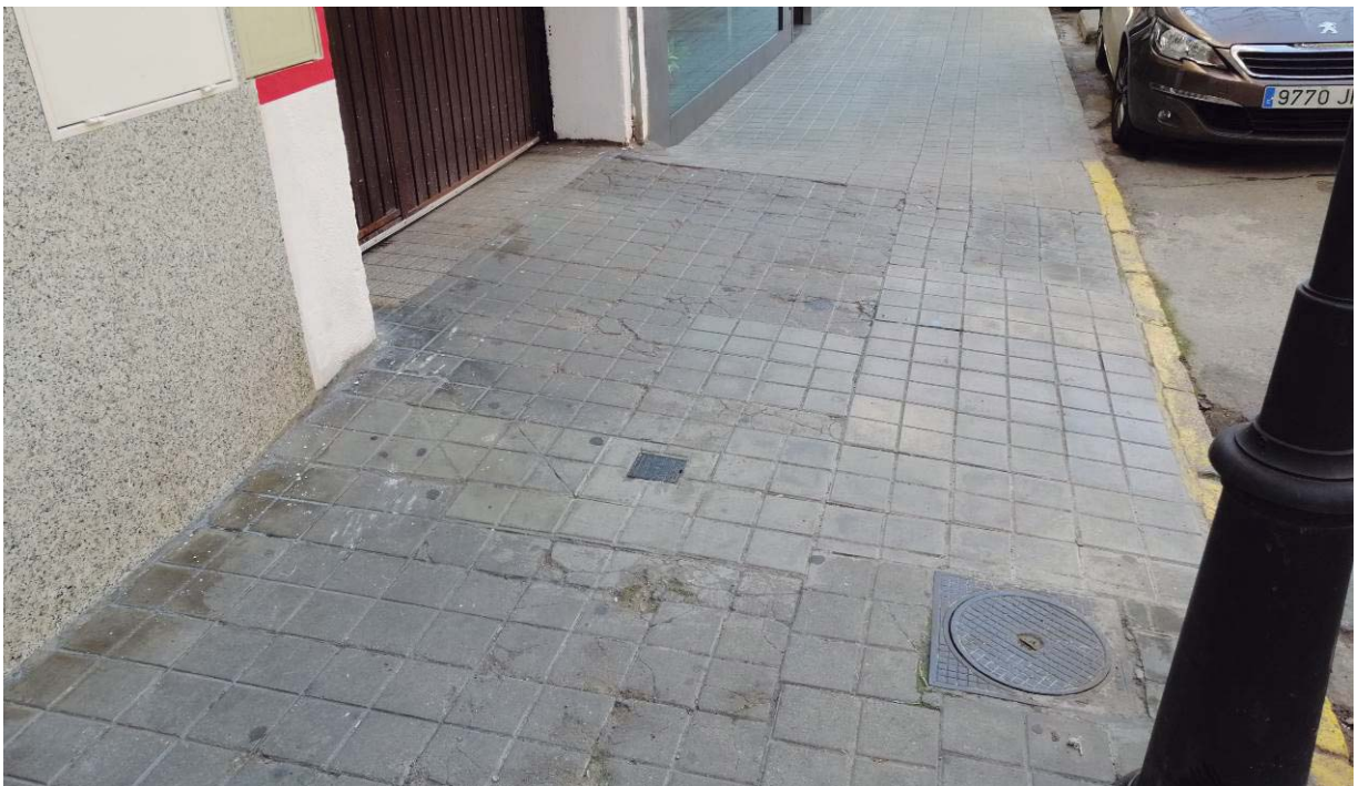
Calle Lentejuela. Pavimento de aceras en mal estado. Bordillos rehundidos.
