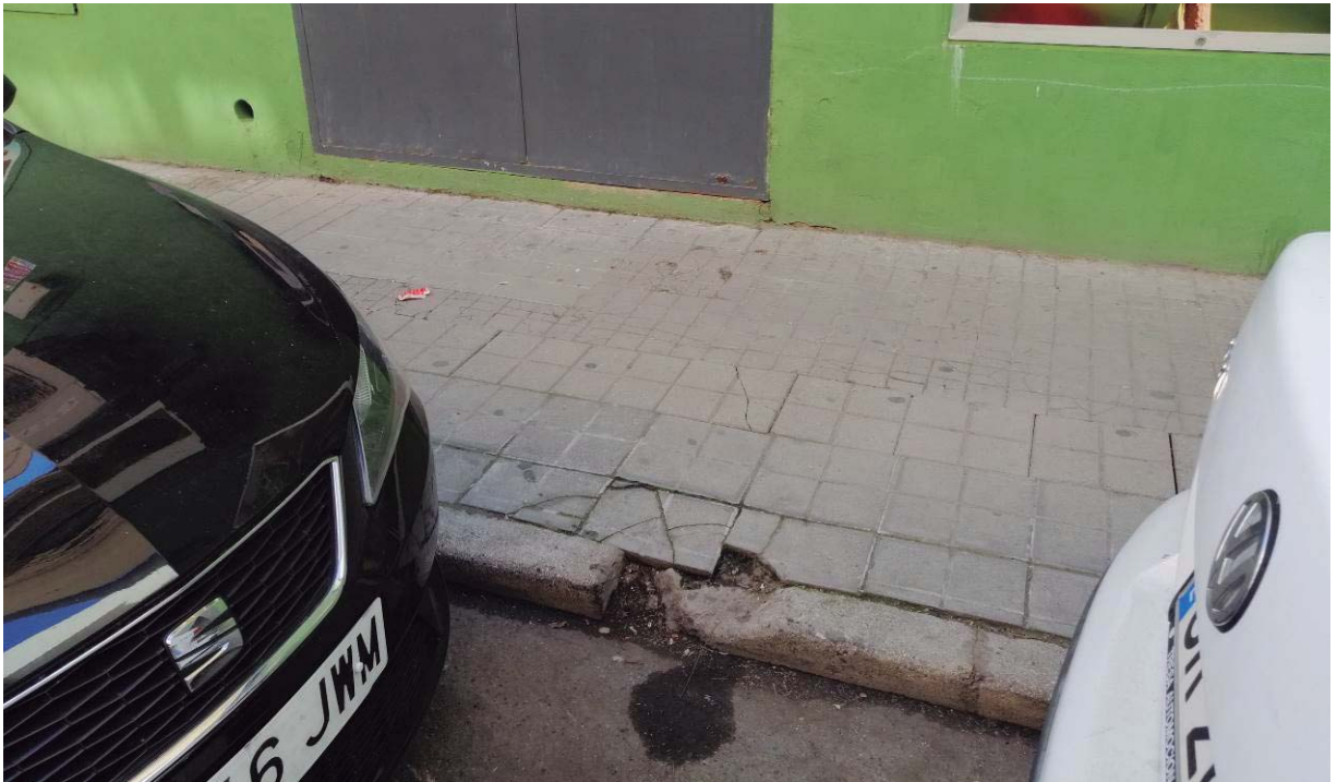
Desperfectos en bordillos y solados (calle Lentejuela).
