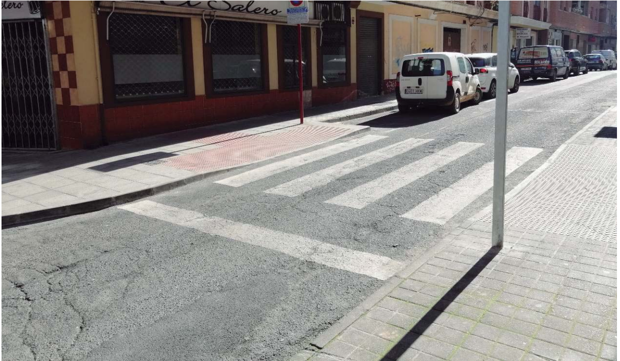
Encuentro de calle Palomares con la calle Morería. Firme en mal estado.
