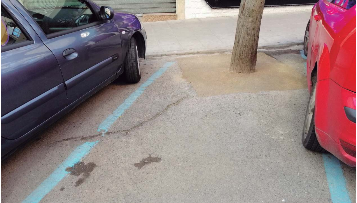
Calle Lentejuela. Alcorques de gran dimensión con fisuras y abombamientos en el asfalto.
