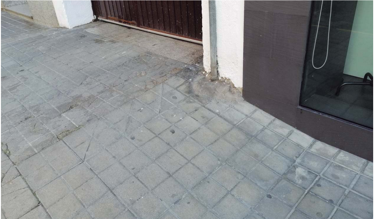
Importante desnivel en acerado por la existencia de vado de bloque residencial.
