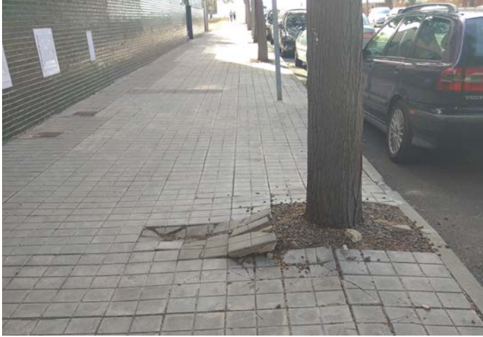
Foto 7 Alcorque en mal estado
