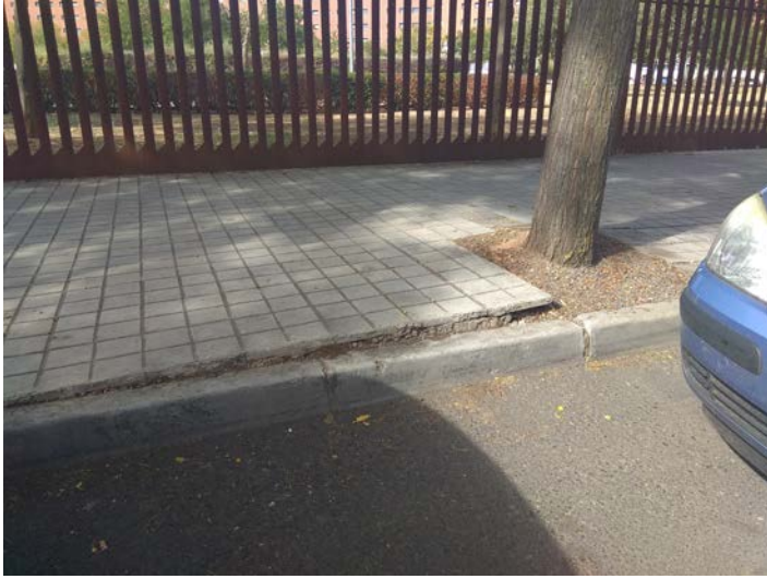
Foto 5. Acerado. Alcorque en mal estado
