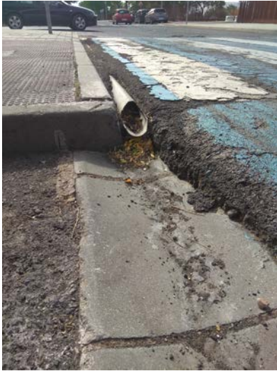
Foto 3. Acerado. Alcorque en mal estado
