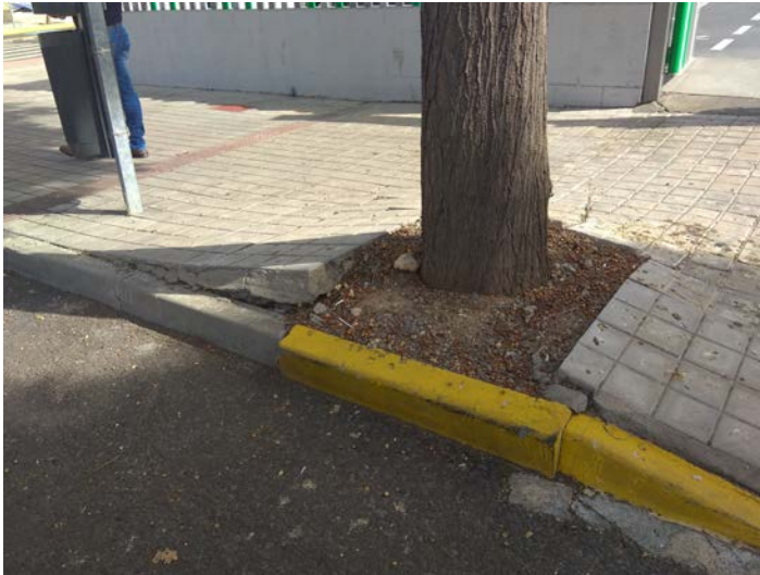
Foto 8. Alcorque en mal estado
