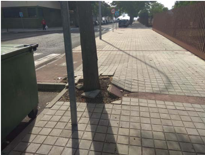
Foto 6. Acerado. Alcorque en mal estado
