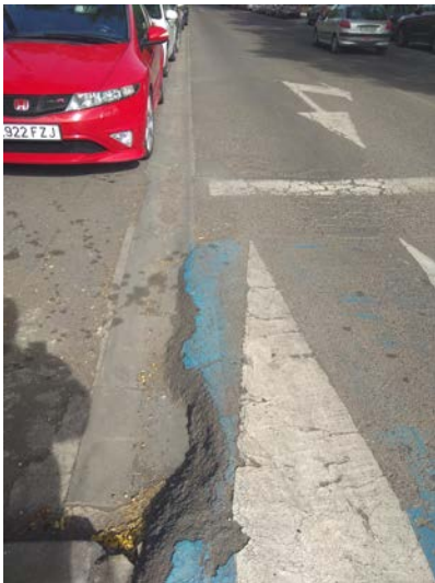
Foto 4. Calzada. Alcorque en mal estado
