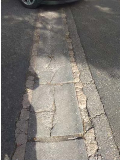
Foto 10. Alcorque en mal estado
