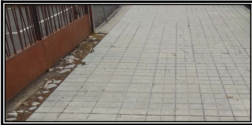
Foto 19. Acerado a reparar
