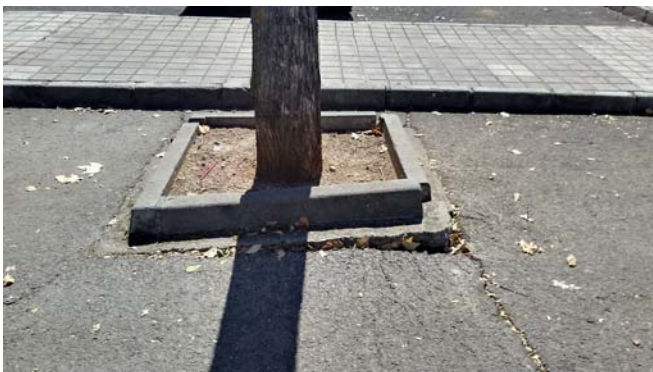
Foto 2. Calzada. Alcorque en mal estado
