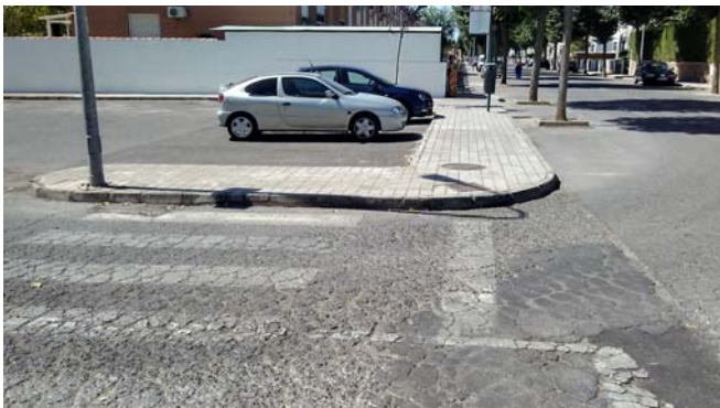
Foto 5. Paso de peatones inaccesible
