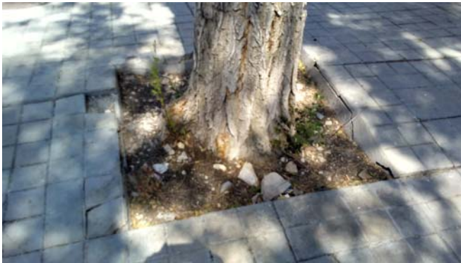
Foto 1. Acerado. Alcorque en mal estado
