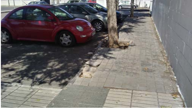
Foto 3. Alcorque en mal estado
